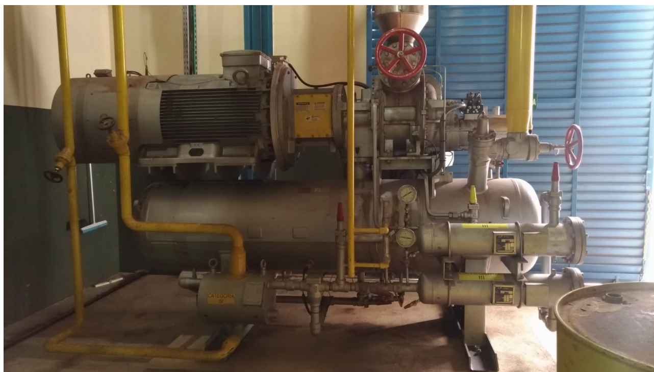
Figura 1 – Compressor de amônia Frick RWF II 177
