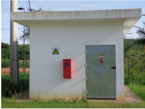
FIGURA 25: Cabine da subestação. Fonte: DInfra
