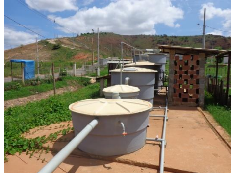
FIGURA 26: Estação de tratamento de esgoto - ETE Fonte: DInfra
