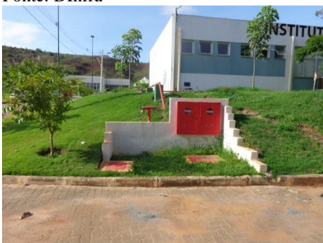
FIGURA 23: Vista externa 1 - Instalações de PCI Fonte: DInfra
