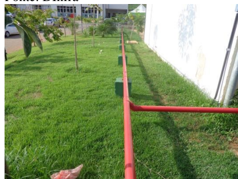
FIGURA 24: Vista externa 2 - Instalações de PCI Fonte: DInfra
