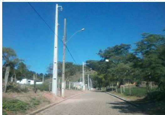
Figura 83 - Nova rede de média e alta tensão 1 em São João Evangelista
