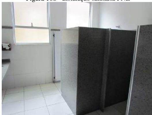
Figura 108 - Instalação sanitária PNE
