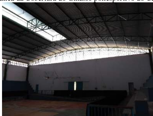
Figura 21 - Vista interna da estrutura metálica da Cobertura do Ginásio Poliesportivo Vista interna da estrutura metálica da Cobertura do Ginásio poliesportivo do Campus Bambuí
