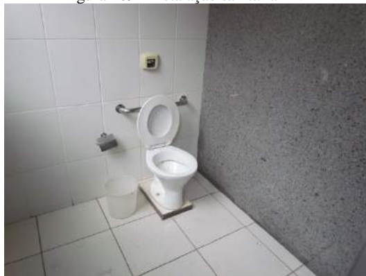
Figura 109 - Instalação sanitária PNE
