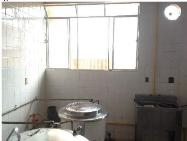
Figura 20 - Vista Interna da Rede de Gases do Restaurante
