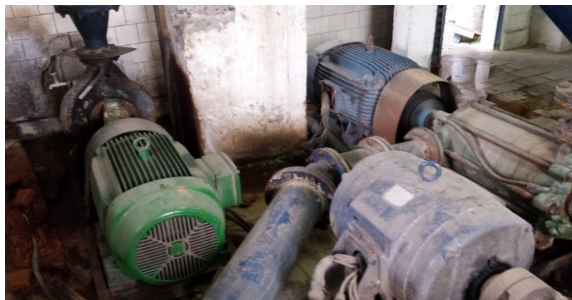
Figura 1- Conjuntos motor-bomba da subestação elevatória.
