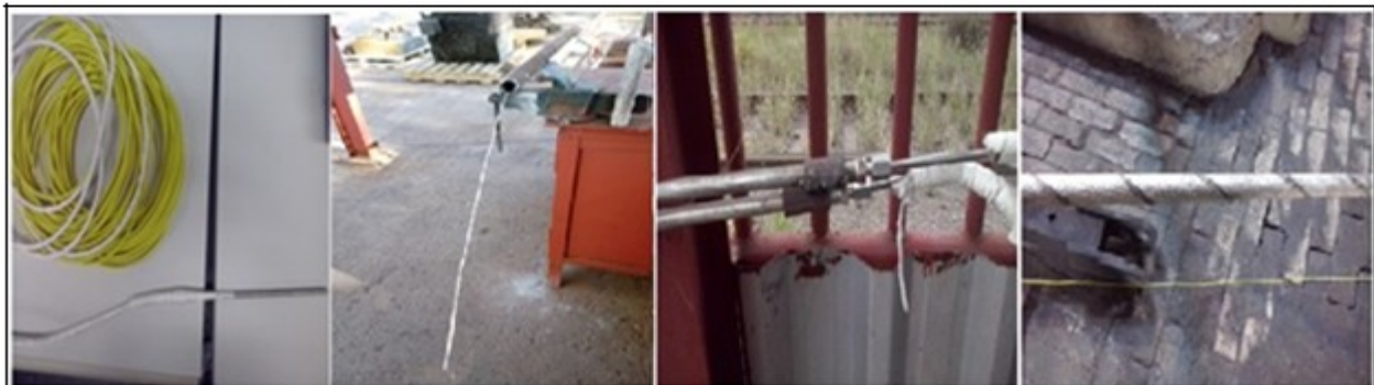
Figura 5 - (a) Cabeamento do termopar do tipo K 8 AWG. (b) e (c) Montagem do termopar tipo K 8 AWG, envolto por um revestimento polimérico e revestido com manta para isolamento térmico, no interior de um
